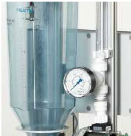
Манометр в Системе Водоснабжения
